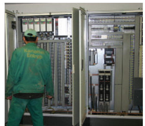
Die Steuerungsanlage von PS sorgt für eine hohe Produktionsleistung sowie Betriebssicherheit.
