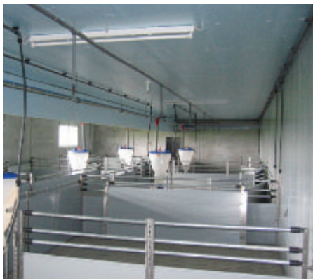
Aufstallung und Zuluft mittels Schlitzlüftung.
