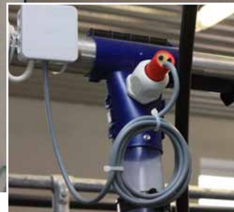
Sensor montiert im PS-Auslauf
