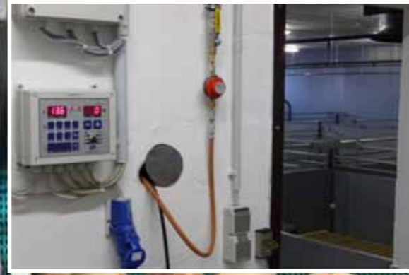
Anschluss des Warmlufterzeugers mit Steuerung über den Klimaregler PS-CS2 vor dem Abteil.
