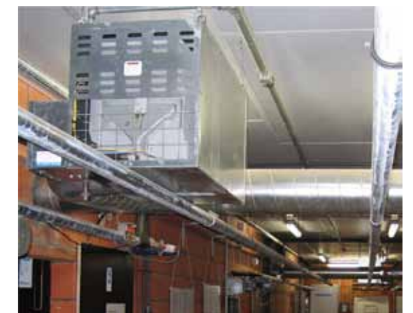
Einbau im Zentralgang eines Schweinemaststalls
