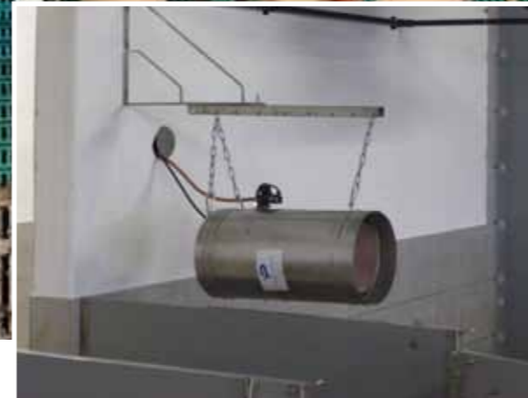
Warmlufterzeuger im Maststall aufgehängt.
