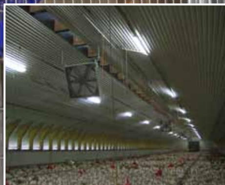
Durchtriebsventilatoren im Putenstall
