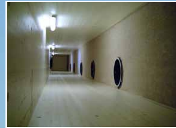
Zentraler Abluftkanal in einem Schweinestall
