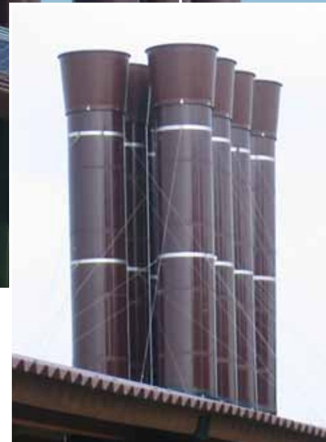
Abluftkamine auf einem Hähnchenstall
