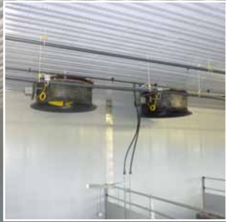
Diffuse Decke mit Absaugpunkten
