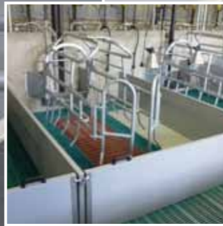
Abferkelkastenstand mit Abferkelbuchtenumrandung
