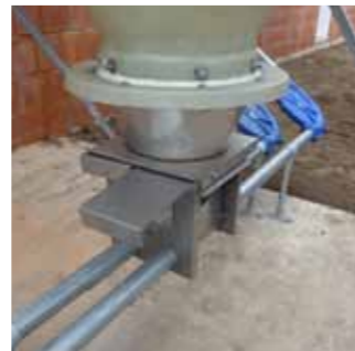
Futteraufnahme-station zweifach mit Siloanschlussstrichter
