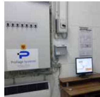
Schaltanlage mit Fütterungs-computer PR-Feed-Control
