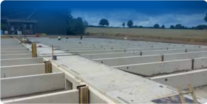
Gülle Keller aus Fertigbetonelementen
